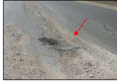
صورة (١) سوء حالة الرصف بأحد شوارع شياخة الملحقات
